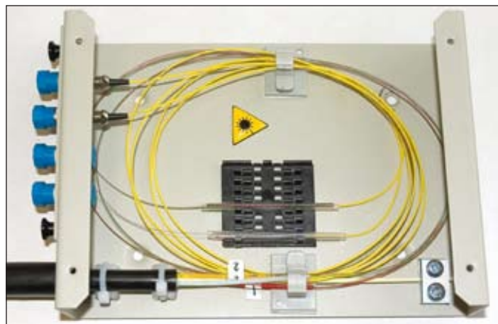
Рисунок 5.4 - Выкладка ОМ, ОВ и pigtail внутри шкафа
