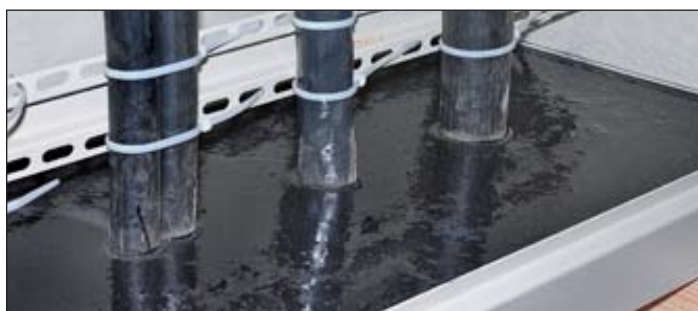
Рисунок 4.3 – Цокольная часть шкафа, полностью залитая герметиком
