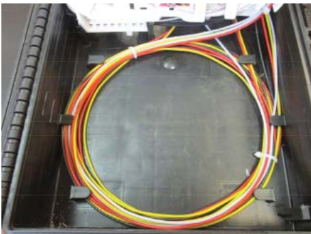
Рисунок А3 – Уложенный запас длин «транзитных» ОК на задней стенке корпуса муфты-красса между направляющими
