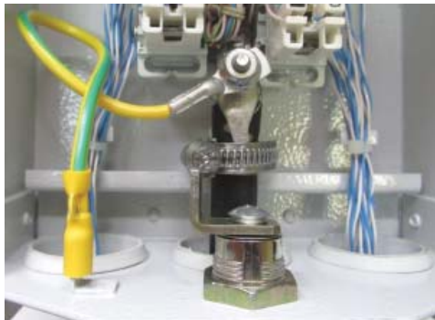
Рисунок 3. Введенный в ЯК кабель с подключенной перемычкой
